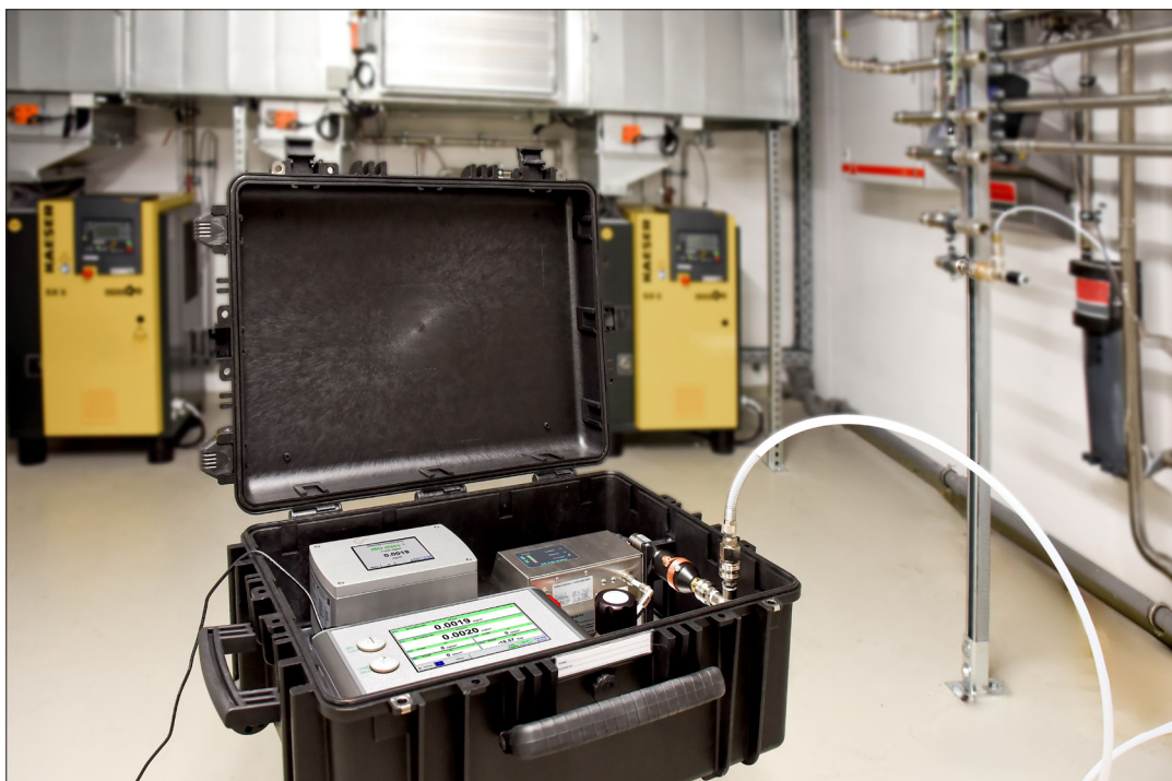
Applikation: Mätning i kompressorrummet - OLJEKONTROLL 500- DS 500 - PC 400
