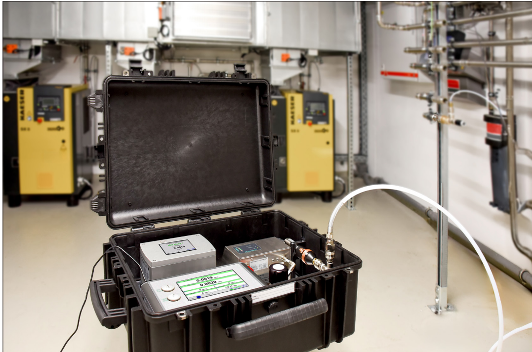
Application : Mesure dans la salle des compresseurs - OIL CHECK 500- DS 500 - PC 400
