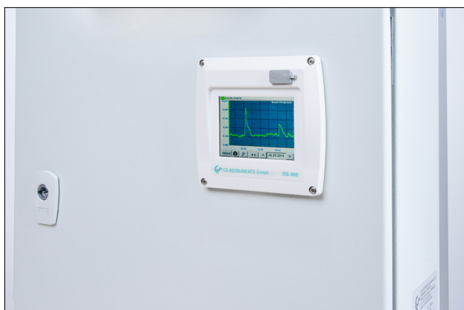
montaje en el armario de distribución
