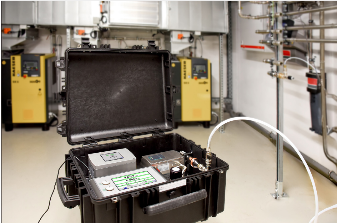
Aplicación: Medición en la sala de compresores – OIL CHECK 500 – DS 500 – PC 400
