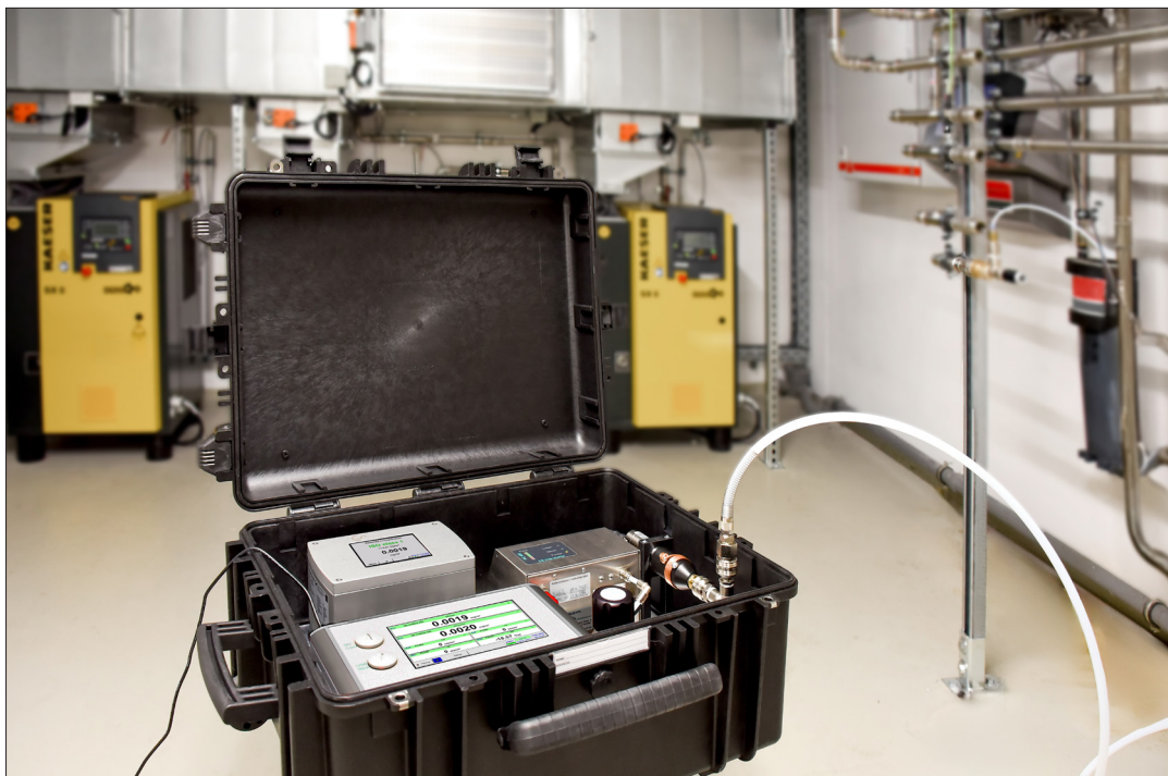
Applicazione: misura nella sala compressori - OIL CHECK 500- DS 500 - PC 400
